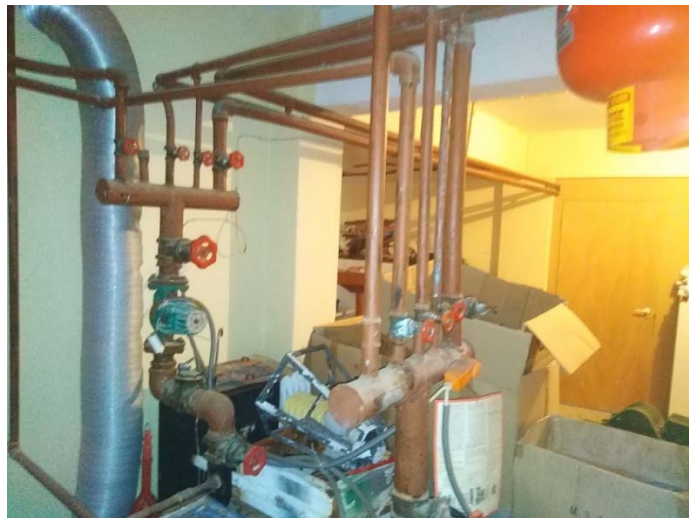
Εικόνα 5: Κυκλοφορητής ζεστού νερού και δίκτυο σωληνώσεων
