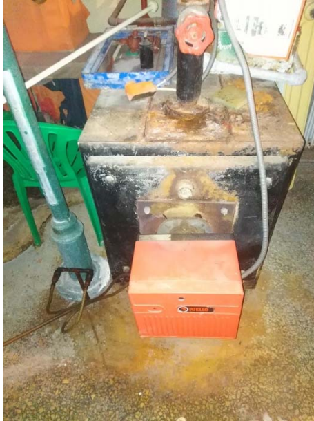
Εικόνα 4: Σύστημα κεντρικής θέρμανσης με λέβητα και καυστήρα πετρελαίου
