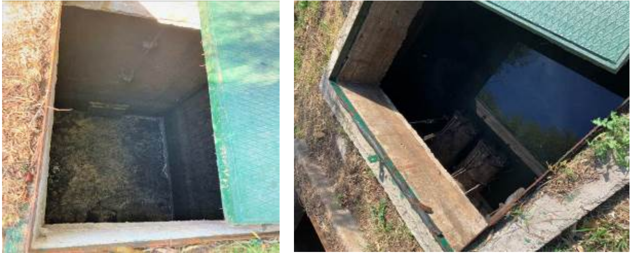
Φωτογραφία Νο 5 & 6 : Φρεάτια ανάντη Α/Σ 1 Μεθάνων
