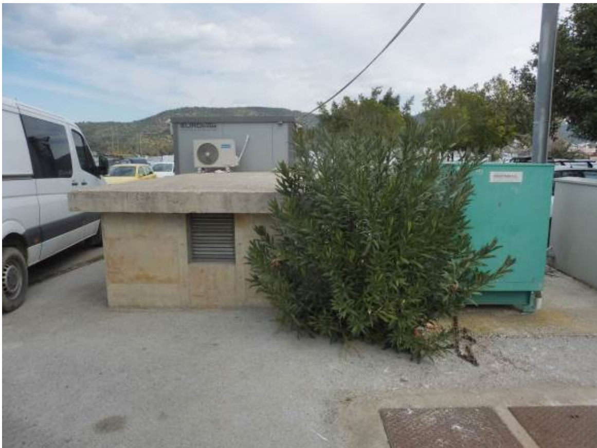
Φωτογραφία Νο 13 : Εγκατάσταση Α/Σ 2 Γαλατά
