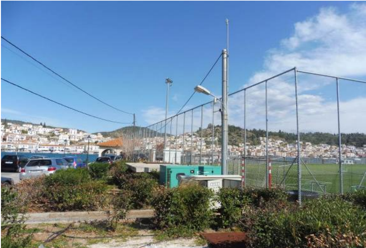
Φωτογραφία Νο 11 : Εγκατάσταση Α/Σ 1 Γαλατά
