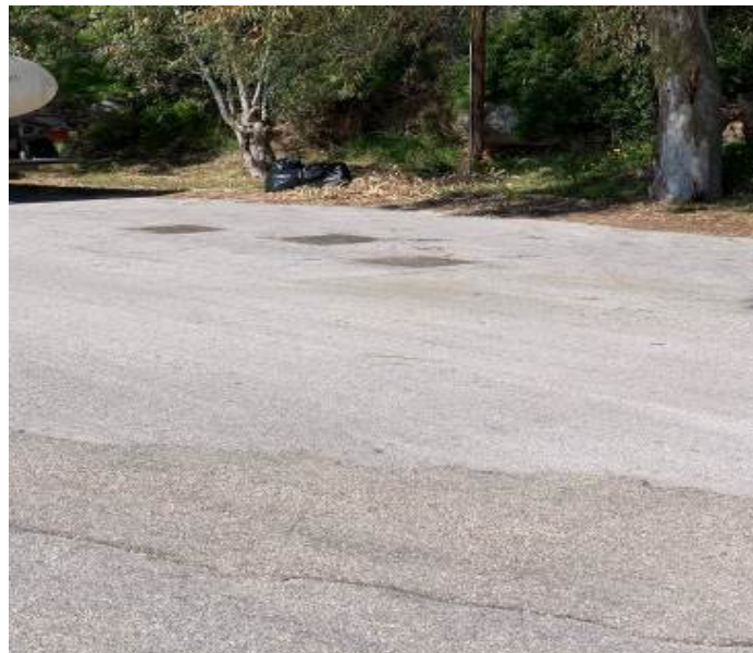
Φωτογραφία Νο 9 : Διάταξη ανάντη φρεατίων Α/Σ 1 Μεθάνων
