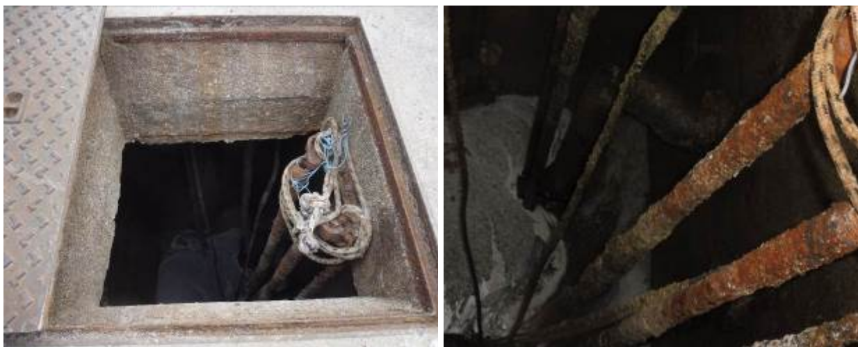
Φωτογραφίες Νο 14 & 15 : Εγκατάσταση Α/Σ 2 Γαλατά
