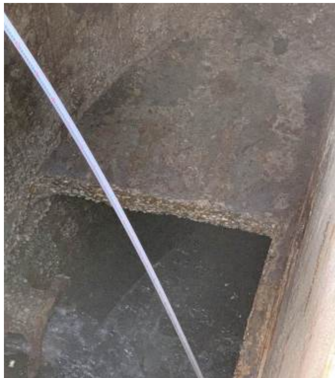
Φωτογραφία Νο 4 : Αγωγός εισόδου στο Α/Σ 1 Μεθάνων
